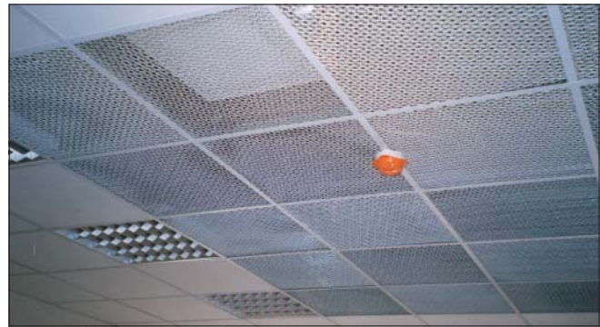
Потолок офиса. Сетка R1/1,4, порошковая краска
